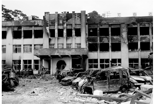
津波と火災の被害にあった門脇小学校 (石巻市)
